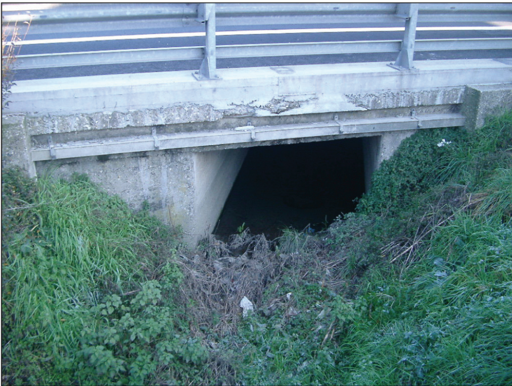
FOTO 5 - Manufatto scolmatore tipo, lato valle
