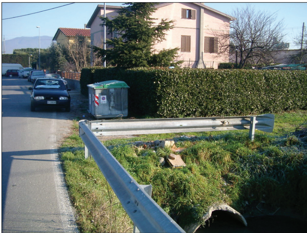
FOTO 1 – Sezione di chiusura bacino 1 – tubazione in calcestruzzo di diametro 100 cm.
