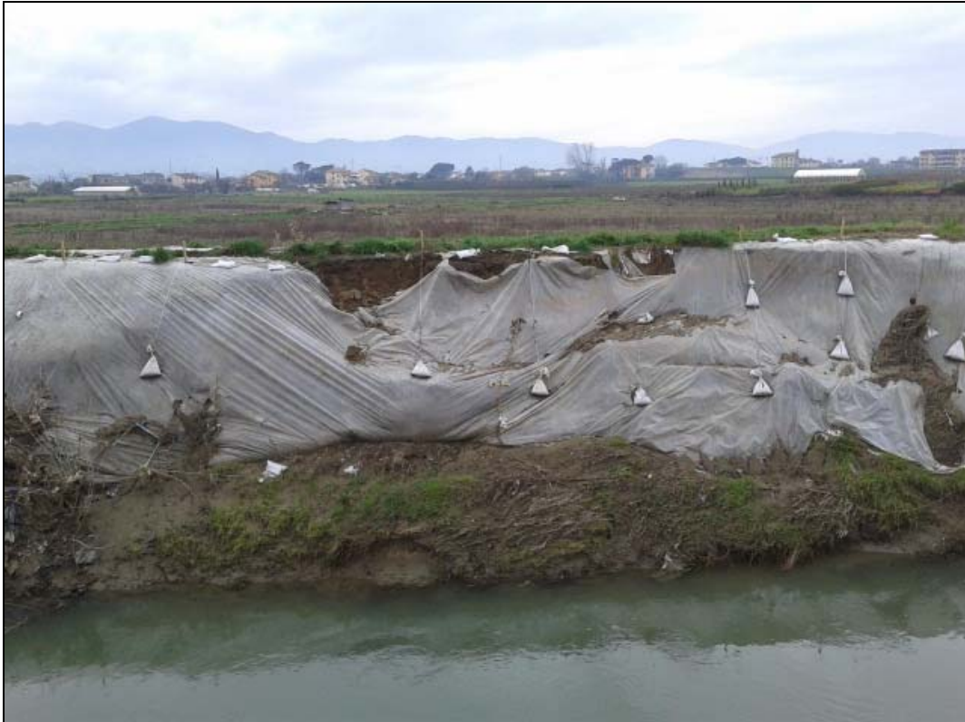
Figura 2-4 - Deterioramento sistemazione nel tratto di intervento a monte del ponte Berlicche.
