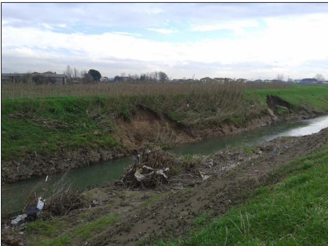
Figura 2-5 – Cedimenti al piede in sponda sinistra nel tratto a valle dell'immissione del f. La Settola.
