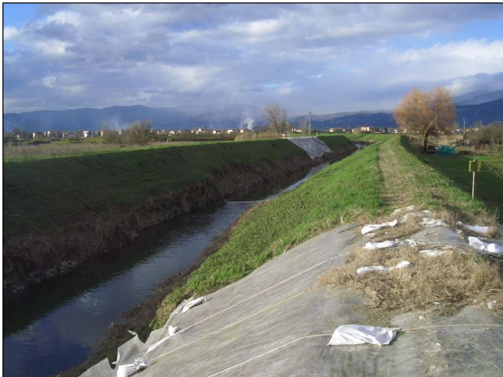
Figura 2-1- Crollo opere murarie a monte del ponte di Berlicche (progetto preliminare, 2011).
