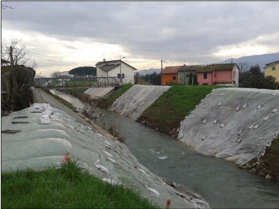
Figura 2-2 - Cedimenti al piede lato fiume a monte del ponte Berlicche.
